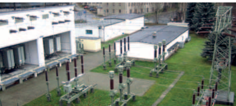
Ein Stromnetzbetreiber hat für den ordnungsgemäßen Betrieb des Stromnetzes zu sorgen. Im Bild das Umspannwerk Gerisch Ruh in Annaberg-Buchholz.
