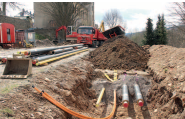
Zum Heizkraftwerk im alten Stadtbad wurden neue Gas- und Fernwärmeleitungen parallel verlegt.
